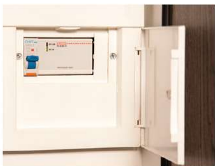
Particolare quadro elettrico Detail electric panel
